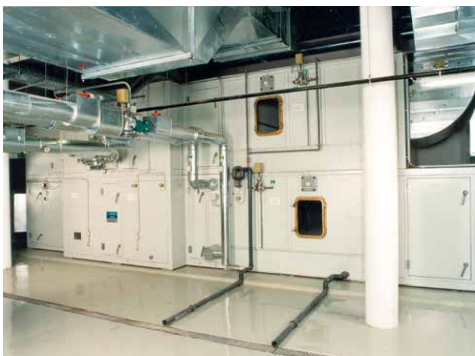
Sichtfenster und Innenbeleuchtung sind zwei der Maßnahmen, die für die regelmäßige Kontrolle von Befeuchtern vorzusehen sind.
