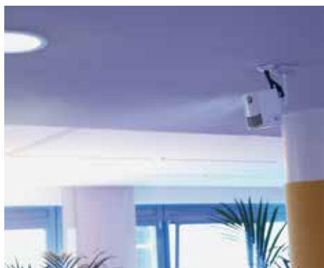
Bei der Hochdruckvernebelung wird das aufbereitete Wasser mikrofein vernebelt, sodass es unmittelbar verdampft.
