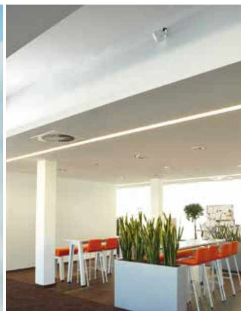
Die Lüfterneuerung übernimmt die Raumlufttechnik (links an der Decke ein Drallausslass). Für ausreichende Luftfeuchte sorgen Hochdruckzerstäuber (rechts oben).
